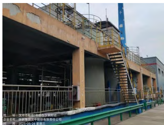
烧结工序罐体设施
